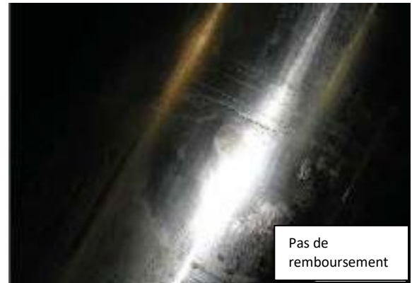
Figure 2 - Tige visiblement fissurée.
