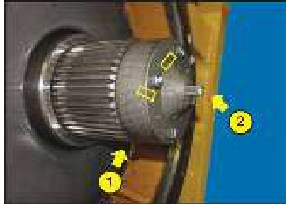
Figure 2 : Pas de fissures ou de dommages visibles sur les cannelures et l'arbre
