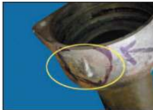
Figure 7 : Dommages non opérationnels - fondu par chalumeau
